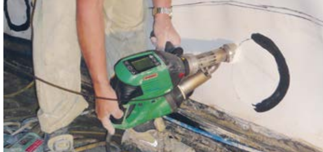
La robusta WELDPLAST S2 en soldadura de un „parche“ en la construcción de túneles.
