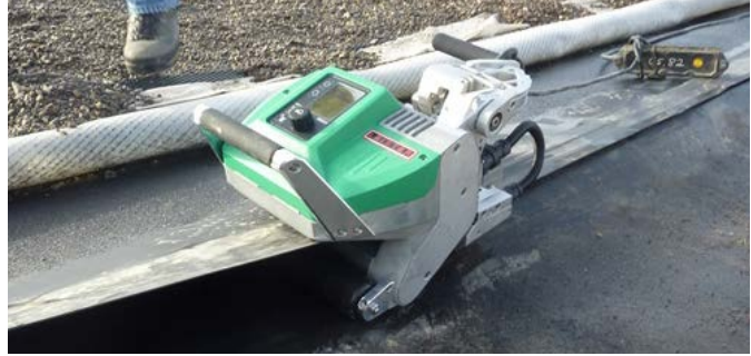
En la prueba de campo (Sudáfrica) el GEOSTAR soldó 240 m en un solo turno de trabajo sin ningún problema
